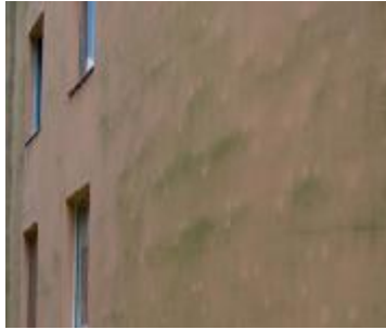
Obr. 1. Fasáda je napadená plísní. Je vidět, že největší napadení je v místech styku polystyrenových desek.
